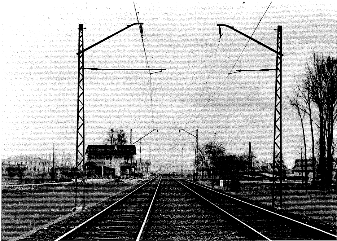
F 8.1.2./1 Elektrifizierung Nürnberg - Saalfeld 1939: Stützpunkte am Schrägausleger zwischen Kronach und Gundelsdorf [BD Nürnberg]
