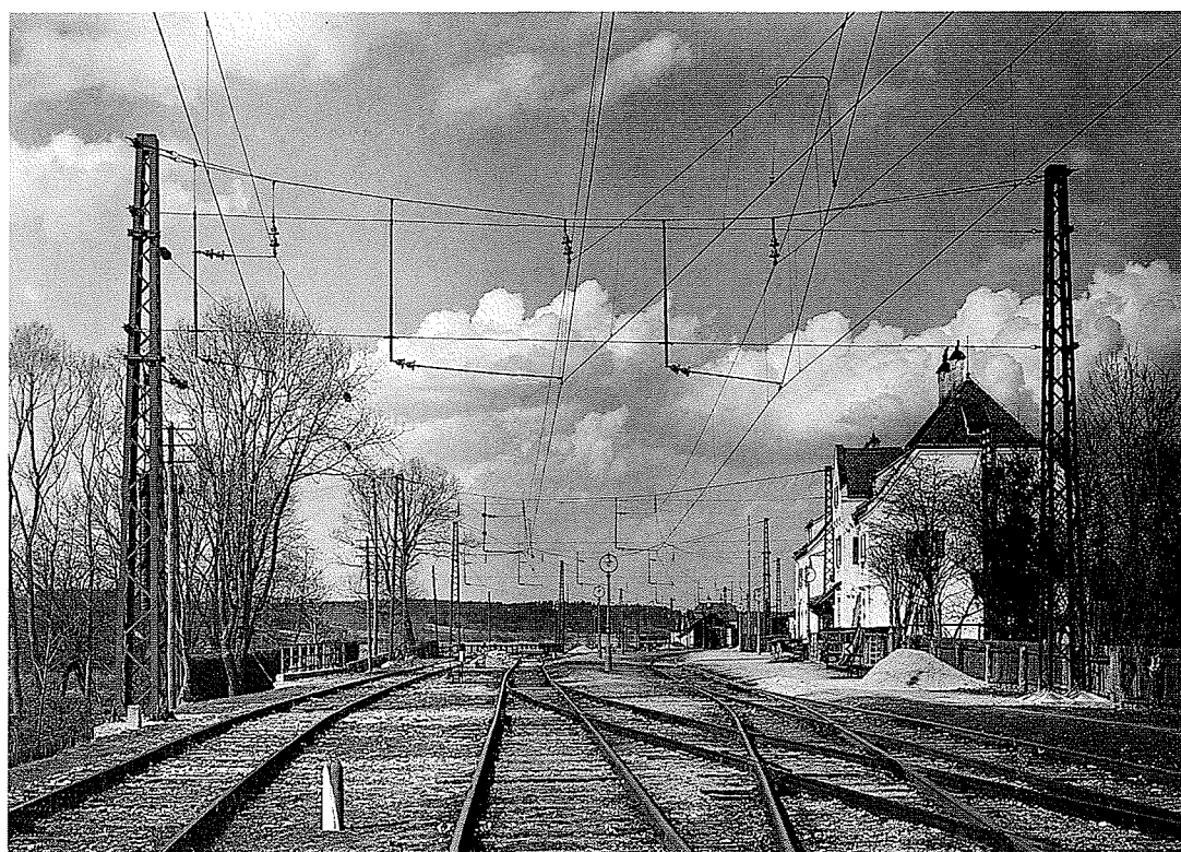
F 5.2.3./4 Elektrifizierung München-Pasing - Herrsching 1925: Querseilaufhängung im Gleisbogen (Bf Herrsching) [SSW, Sammlung Jilek]
