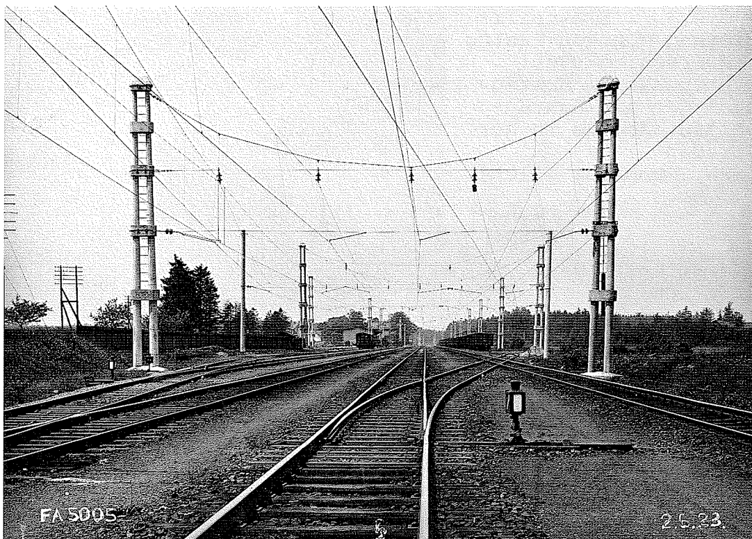
F 4.2./5 Elektrifizierung Lauban - Görlitz 1923: Querseil- aufhängung mit Schleuderbetonmasten im Bahnhof Nikolaus- dorf [SSW 2.06.1923, Sammlung Jilek]
