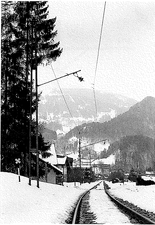
F 13.9.3./4 Systemumstellung Bludenz - Schruns 1972: Stützpunkt der Einfach-Fahr- leitung bogenaußen [Schwach 1984]
