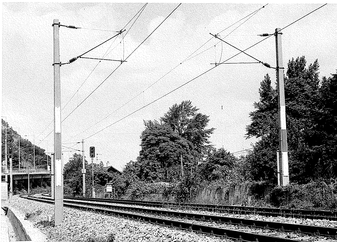
F 13.8.3.3./1 Elektrifizierung Wien FJBf - Tulln Stadt 1978: Ausleger- stützpunkte zwi- schen Nußdorf und Klosterneu- burg bei Kahlen- bergerdorf [Schwach 1987]
