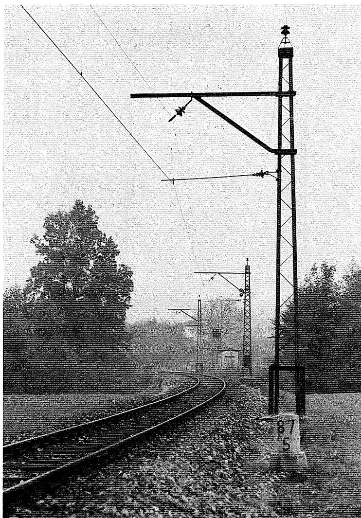
F 13.5.1.1./3 Elektrifizierung Ebensee - Att- nang-Puchheim 1924: Ausleger- stützpunkt zwi- schen Traunkir- chen und Altmün- ster [Schwach 1985]
